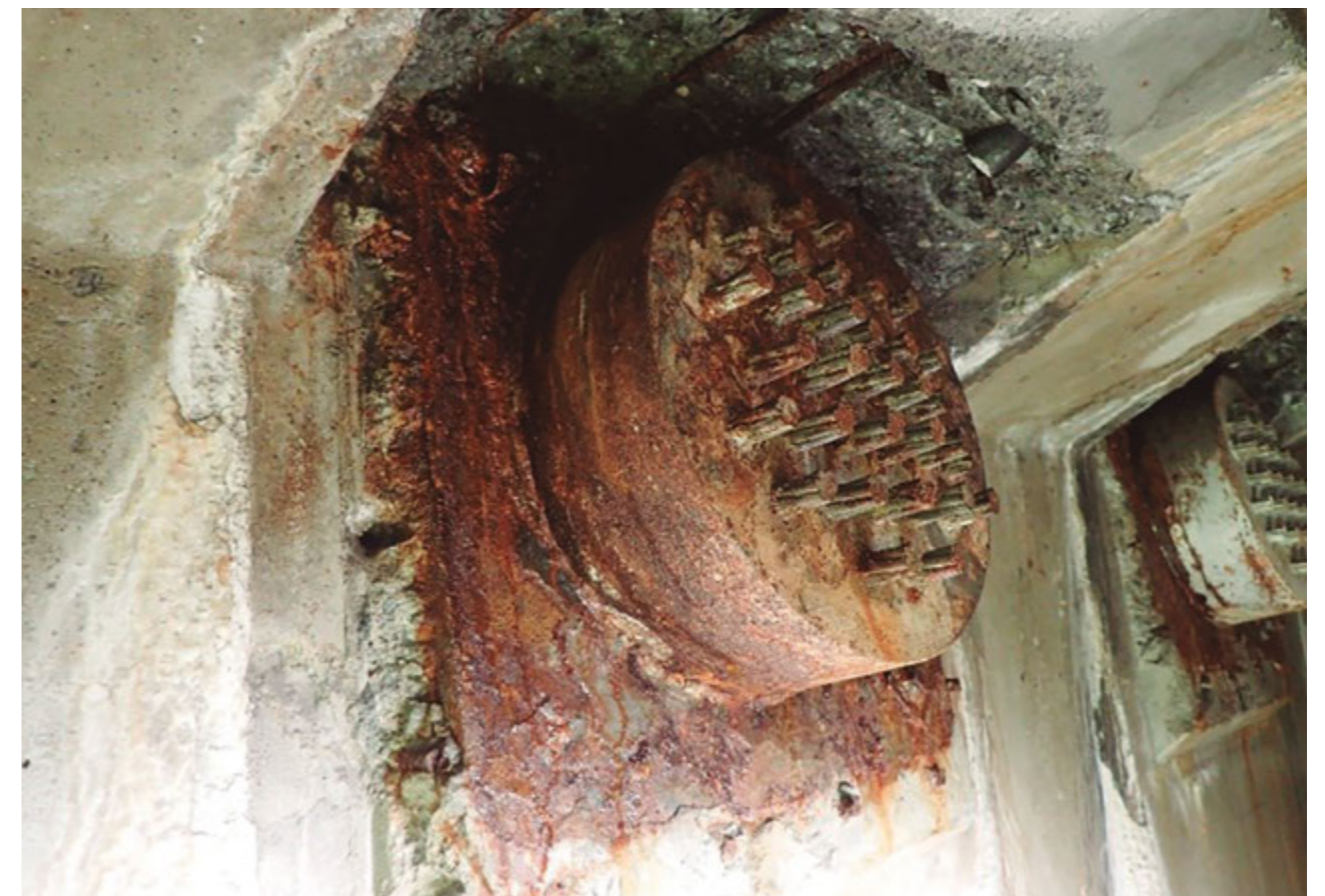
Cabeza de anclaje de un tendón de postesado con corrosión
