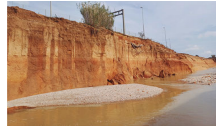
Vista de la erosión producida en las proximidades del ramal de la A-3 (actuación 2)
