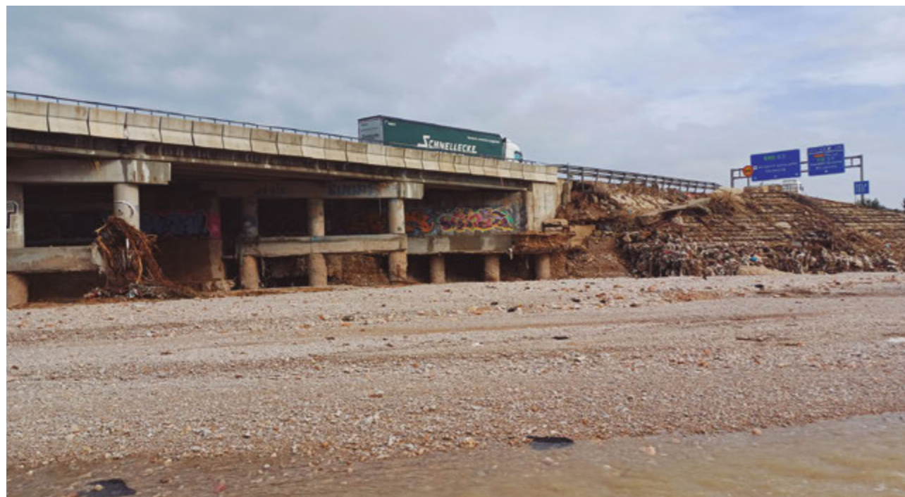
Vista de la erosión que ha sufrido el viaducto de la A-3 sobre el barranco del Poyo (actuación 1)
