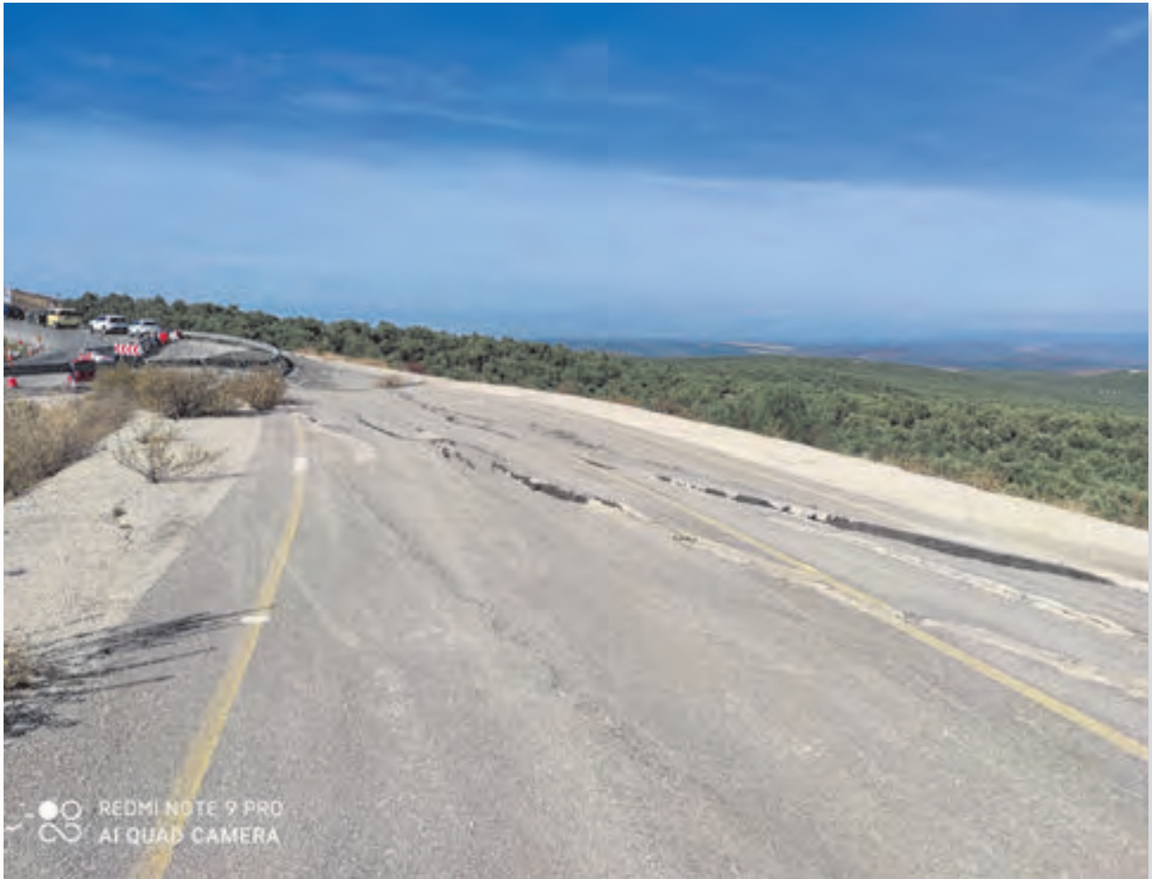
Figura 2. Estudios de patologías geotécnicas en carreteras. Enlace de Canena (Jaén).
