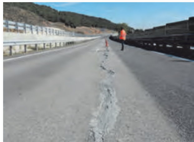
Grietas en el firme en la calzada derecha.
