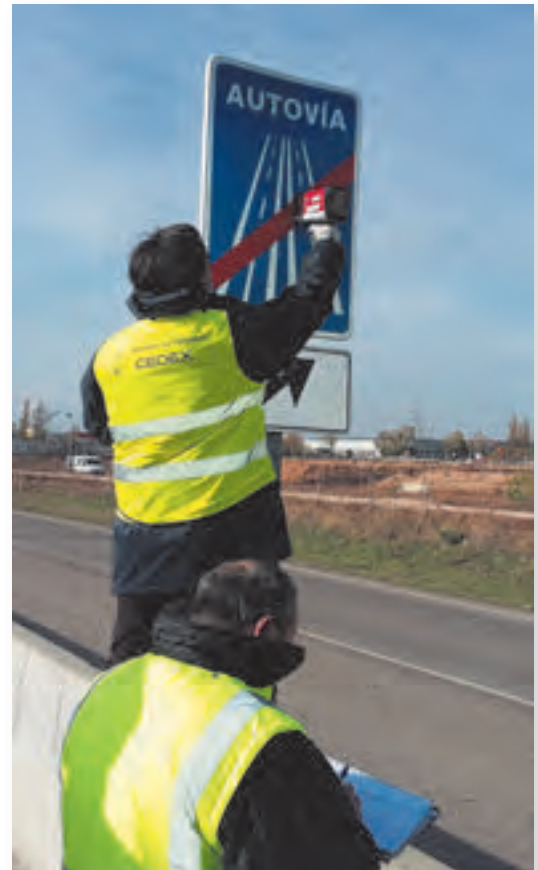
Medida de coeficiente de retrorreflexión de señales verticales en la autovía A-4 tramo 3.
