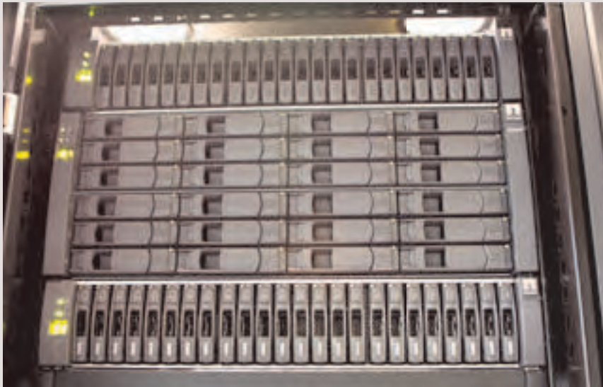
Cabina NetApp FAS 2552.
