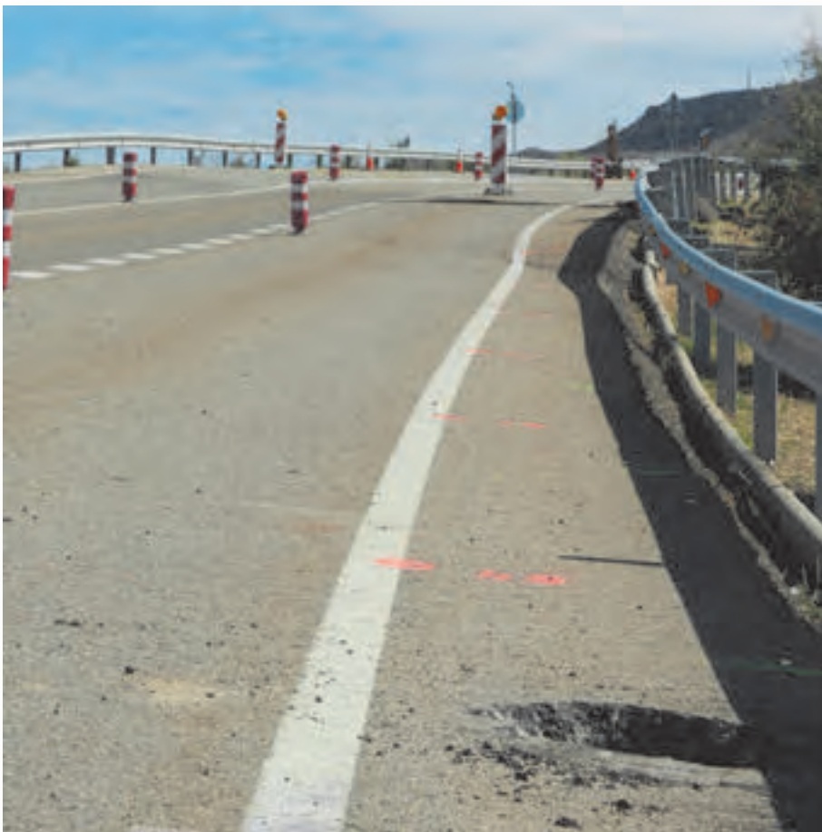
Figura 1. Estudio de patologías geotécnicas de carreteras para la DGC. Variante de La Escucha (Teruel).
