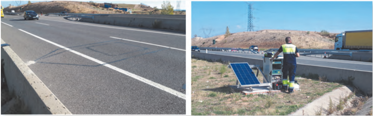
Figura 2. Aspecto de los sensores de peso y el lazo de inducción instalados en la calzada. Técnico de la empresa instaladora verificando los equipos electrónicos alojados en un armario de intemperie, al lado del panel solar para suministro de energía eléctrica.
