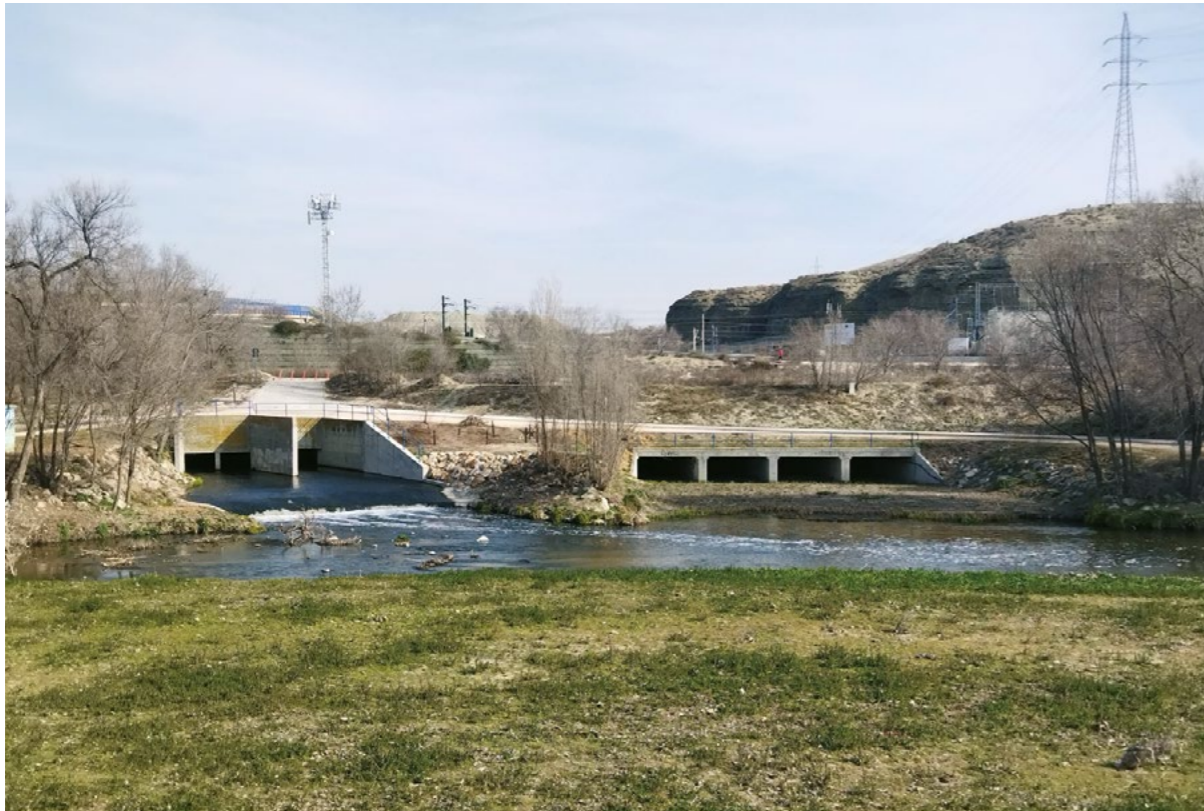
Aliviaderos de la EDAR de La Gavia y del arroyo de La Gavia, en la margen izquierda del río Manzanares.
