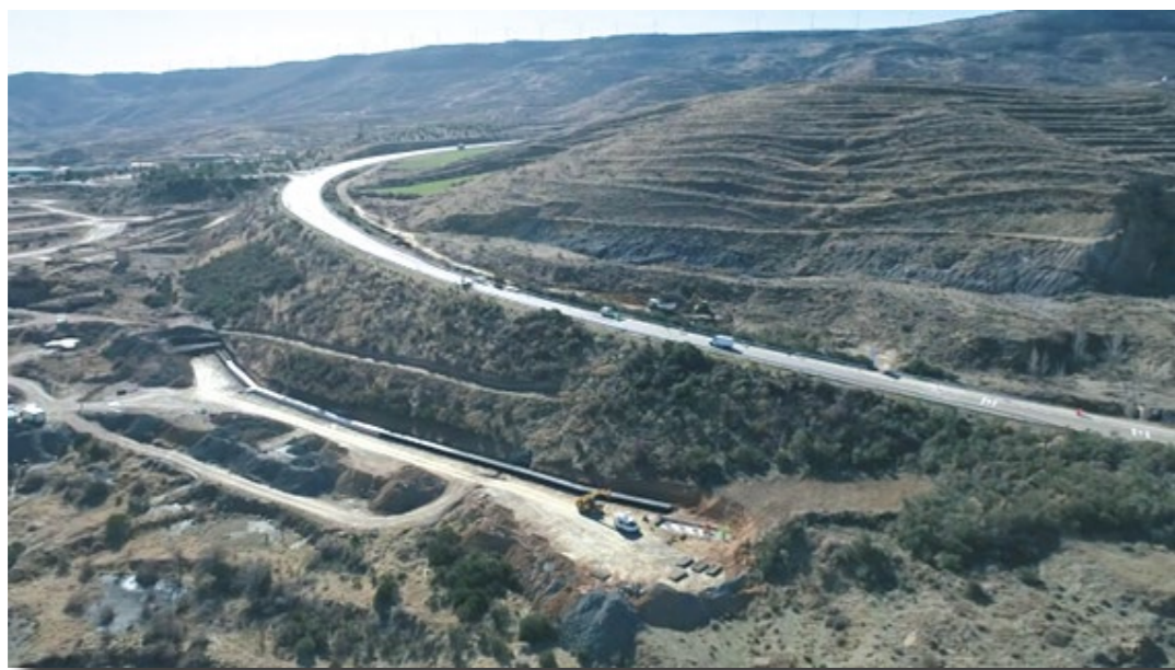
Vista del tramo de la N-420 con patología de naturaleza geotécnica.
