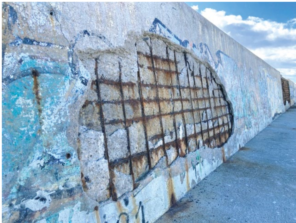
Daños típicos en estructuras costeras.
