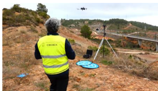
Trabajos con drones para la obtención de la nube de puntos del viaducto
