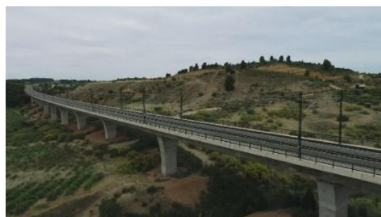
Viaducto instrumentado para el proyecto ERJU
