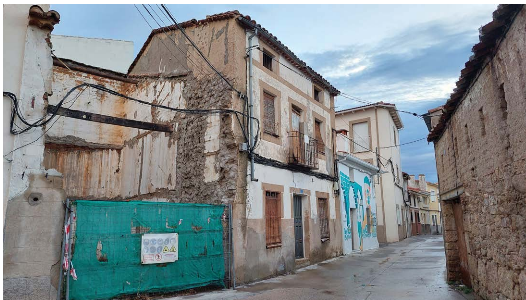
Fig. 15 / El abandono y la ruina de la arquitectura tradicional. Ejemplos en Bohonal de Ibor, Cáceres
