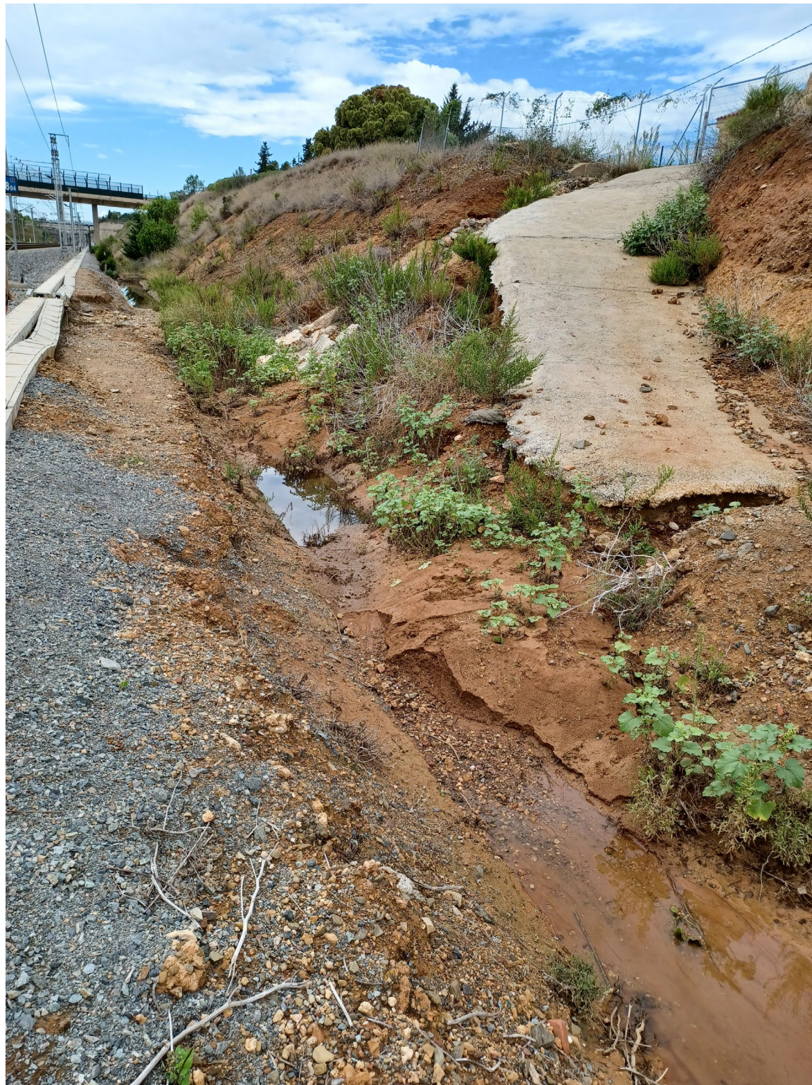
Imagen punto vaguada colgada en PK 32+000 línea Valencia Tarragona existente. Fuente propia
