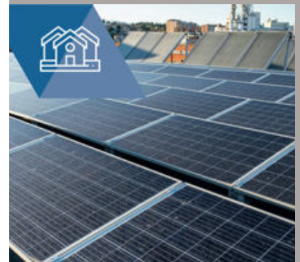
Fig.134 Placas solares de la escuela Municipal de Treball
