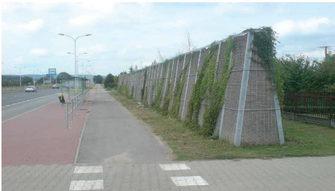
Figura 24: Pantallas acústicas vegetalizables con estructura portante interior.
