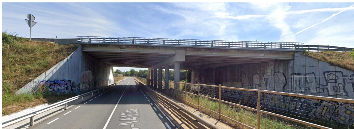
Figura 1. Paso superior de la autovía C-17. Esta estructura es adecuada para permitir la duplicación de vía junto al estribo sur
