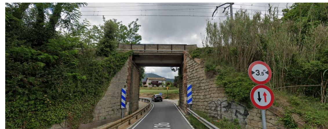
Figura 2. Paso inferior existente en la carretera C-1413b. Con el fin de no producir un estrangulamiento en la carretera, lo más razonable sería construir una nueva estructura de vía doble.
