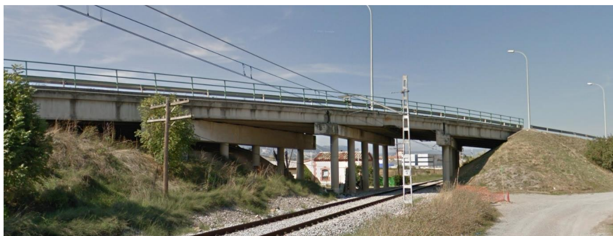
Figura 5. Paso superior situado en el P.K. 67+239. Para aprovechar la estructura existente, la duplicación de vía tendrá que discurrir por el vano central izquierdo
