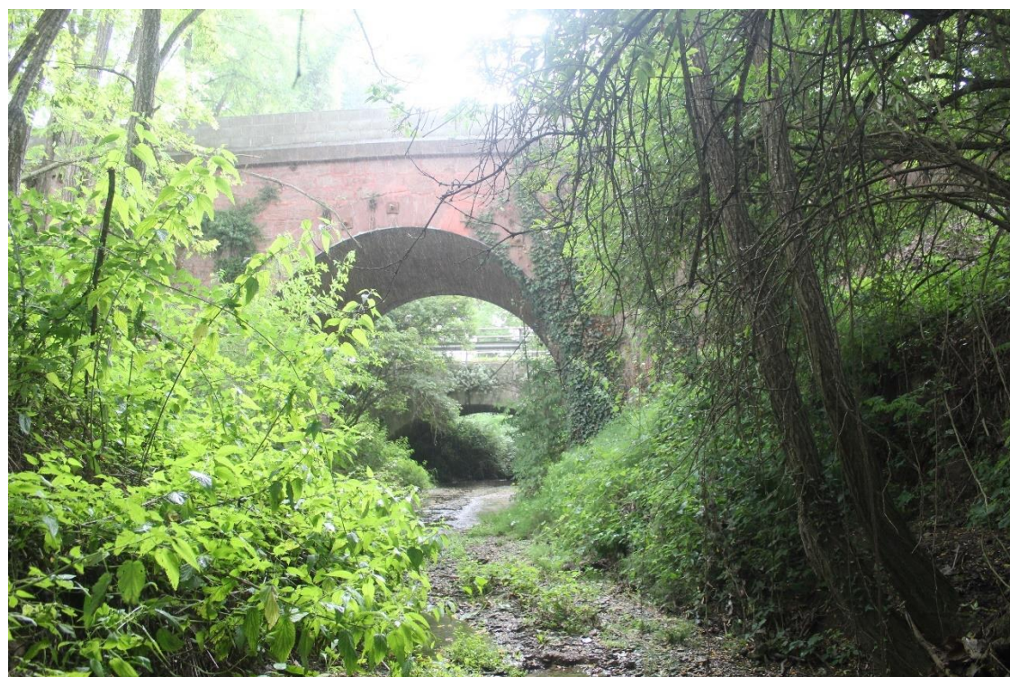
Fotografía 21. Estructura de drenaje situada en la actual vía del ferrocarril en el Torrent de la Serreta I (o torrent de L'Albereda).
