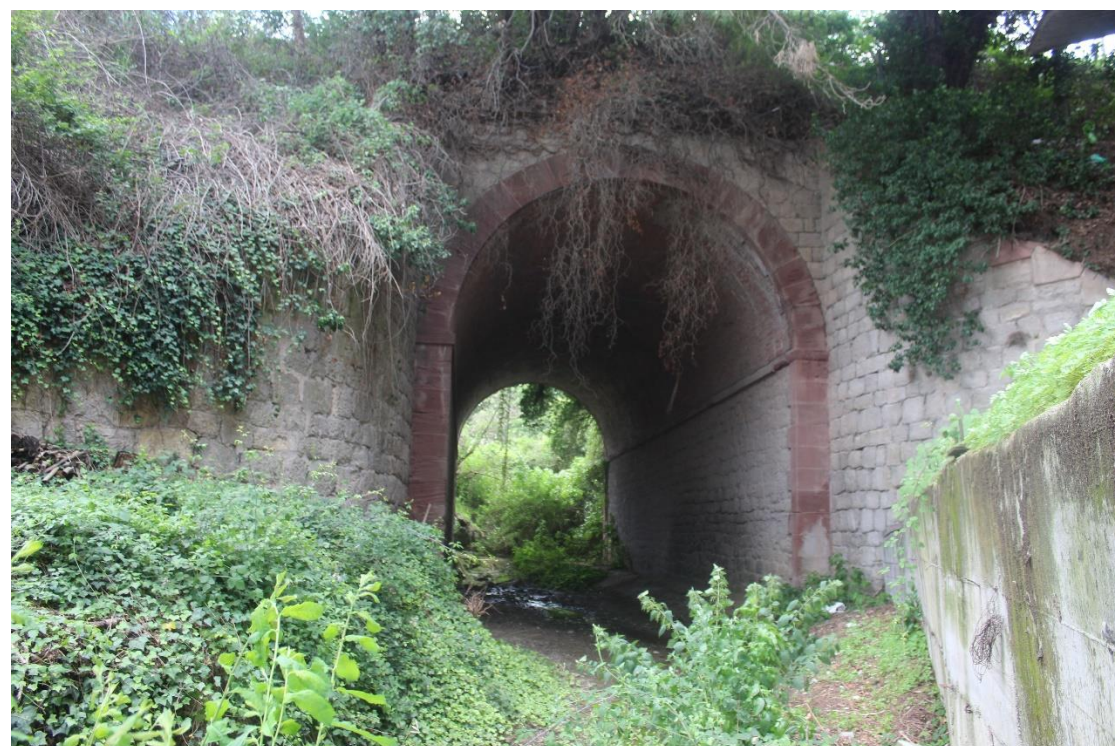
Fotografía 17. Estructura de drenaje situada en el río Congost en Balenyà.
