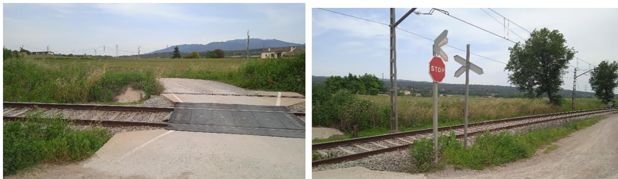
Figura 29. Imágenes del paso a nivel existente en el PK 57+313 de la vía actual.
