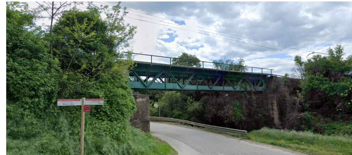
Figura 20. Viaducto existente en el P.K. 64+800 que salva una carretera local y la Riera de Tona.
