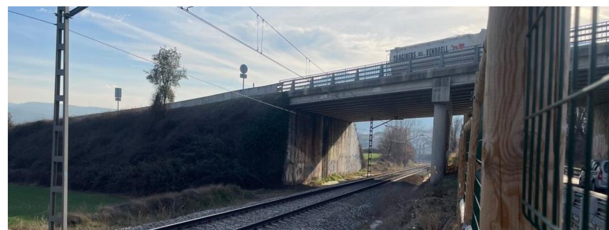
Figura 5. Pas superior de l'autovia C-17. Aquesta estructura és adequada per permetre la duplicació de la via al costat de l'estrep sud
