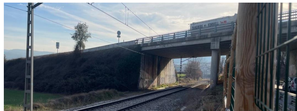
Figura 5. Paso superior de la autovía C-17. Esta estructura es adecuada para permitir la duplicación de vía junto al estribo sur
