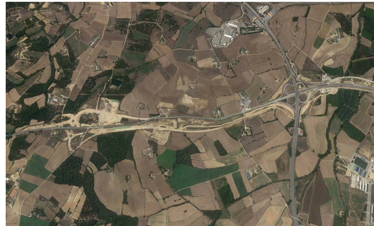
Figura 2.- Estado de las obras rescindidas del Tramo: enlace Vidreres a 27 de julio de 2018
