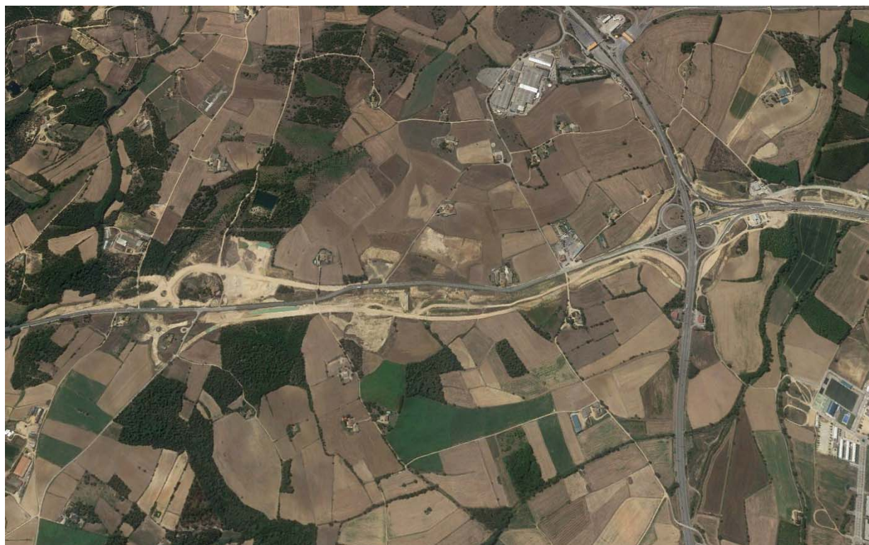
Figura 1.- Estado de las obras rescindidas del Tramo: enlace Vidreres a 27 de julio de 2018
