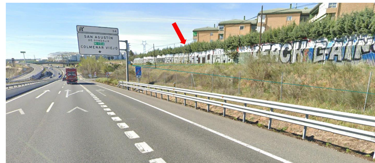
Fotografía 32. PT-16. Tronco A-1. Pantalla acústica obsoleta a la que discurrirá paralela
