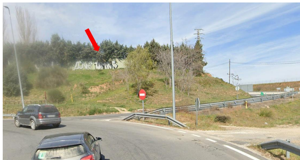
Fotografía 30. PT-16. Ramal de salida. Pantalla acústica obsoleta a la que discurrirá paralela
