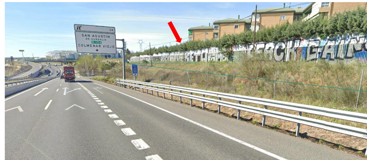
Fotografía 33. PT-16. Tronco A-1. Pantalla acústica obsoleta a la que discurrirá paralela
