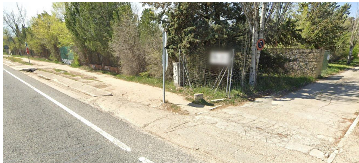
Fotografía 7. PT-5. No existe sistema de contención actualmente
