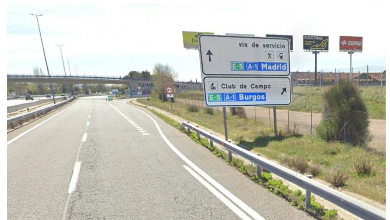
Fotografía 13. PT-9. Barrera hasta la que se prolonga la de nueva implantación
