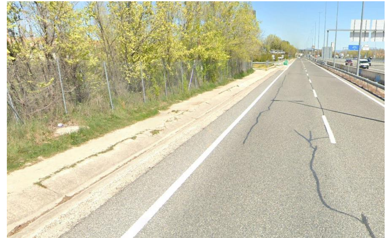
Fotografía 8. PT-6. No existe sistema de contención actualmente
