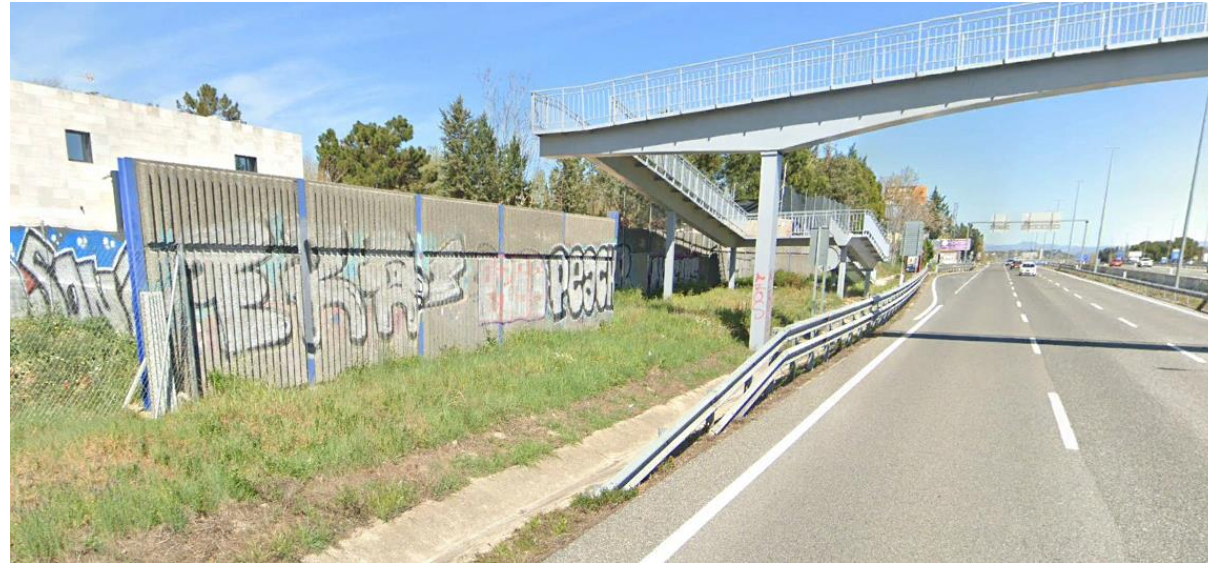
Fotografía 2. PT-1. Barrera de doble altura a partir de la pasarela peatonal PK 0+235
