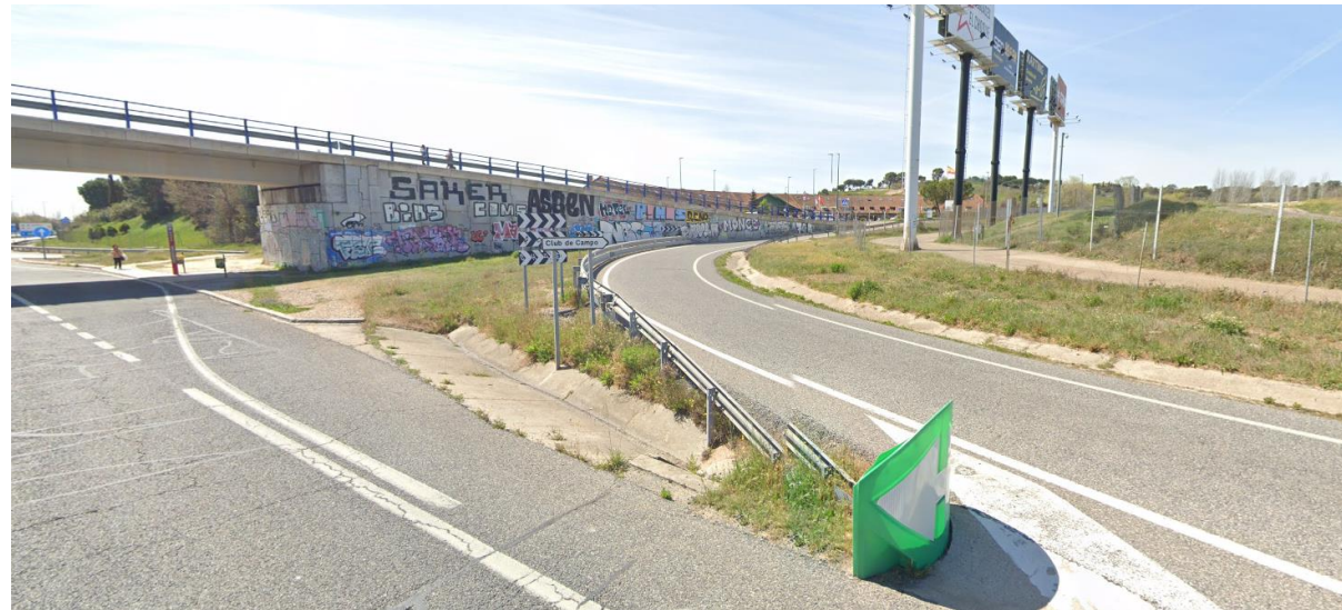
Fotografía 11. PT-8. Actualmente sin barrera en el tronco. Barrera en el ramal. Hito de divergencia ("obispo")
