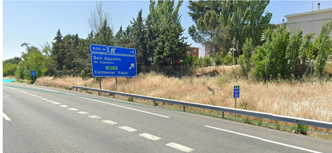
Fotografía 37. PT-18. Barrera metálica para protección de postes de cartel de señalización
