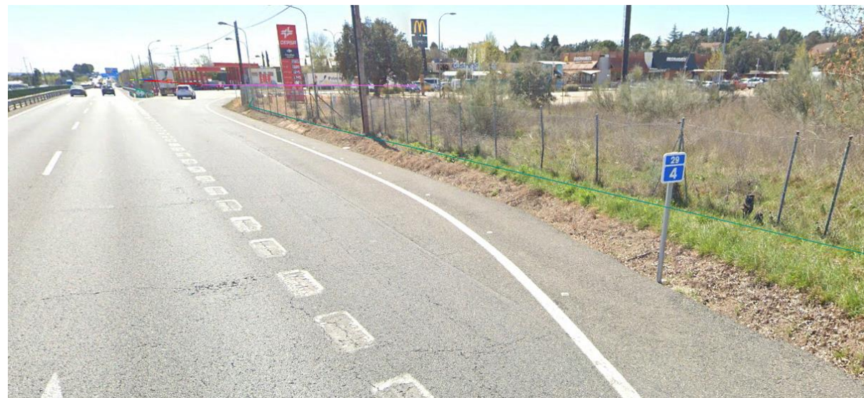
Fotografía 26. PT-14. Vista del tramo en la salida a la estación de servicio
